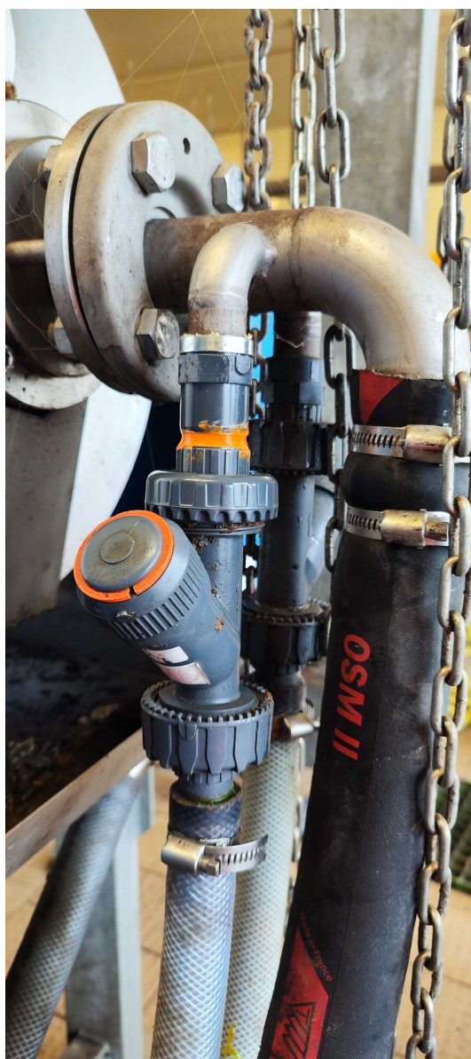
Remplacement nourrice d'alimentation centrifugeuse :
